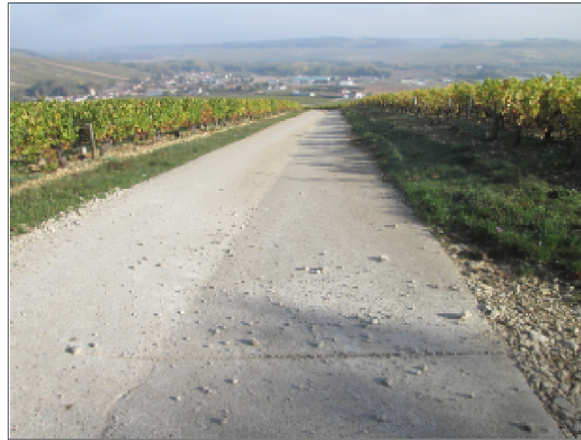
Photo n°19 : Vue du chemin imperméabilisé avec concentration des écoulements au centre vue en direction de CHABLIS
